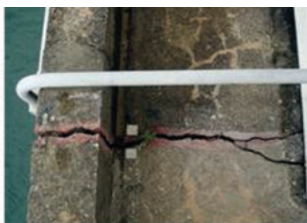
Fissuras na mesma barragem atingindo 10 mm.
