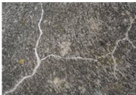
Detalhe da fissura preenchida com material branco 1 .
