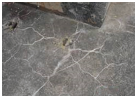
Fissuração tipo mapa em uma barragem.
