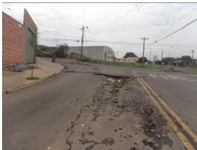
Figura 10 - Erosão de sub-superfície que compromete o asfaltamento em rua do Jardim Centenário. Acervo pessoal. Foto de maio/2016.
