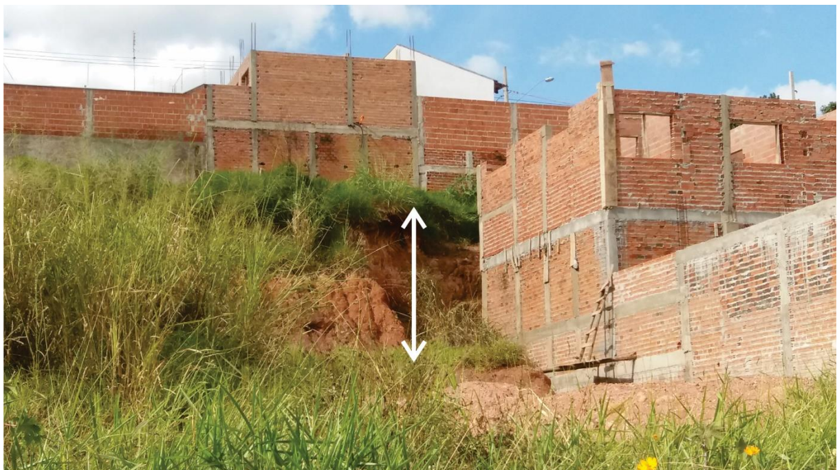
Figura 6 - Corte com altura excessiva no Residencial Jardim dos Bosques. Acervo pessoal. Foto de maio/2016.
