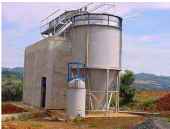
Figura 9 – Reator anaeróbio de manta de lodo
