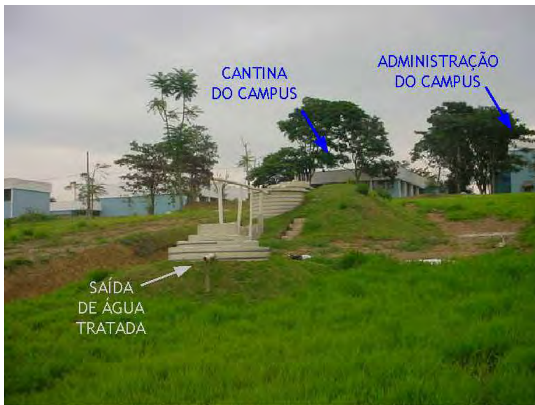
Figura 2 – Mini-estação de tratamento de esgoto implantada na UNESP, campus de Guaratinguetá (vista frontal)
