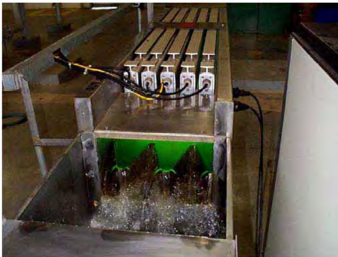
Figura 16 – Sistema com lâmpadas ultravioleta para desinfecção do esgoto (CEOLATO, 2003)
