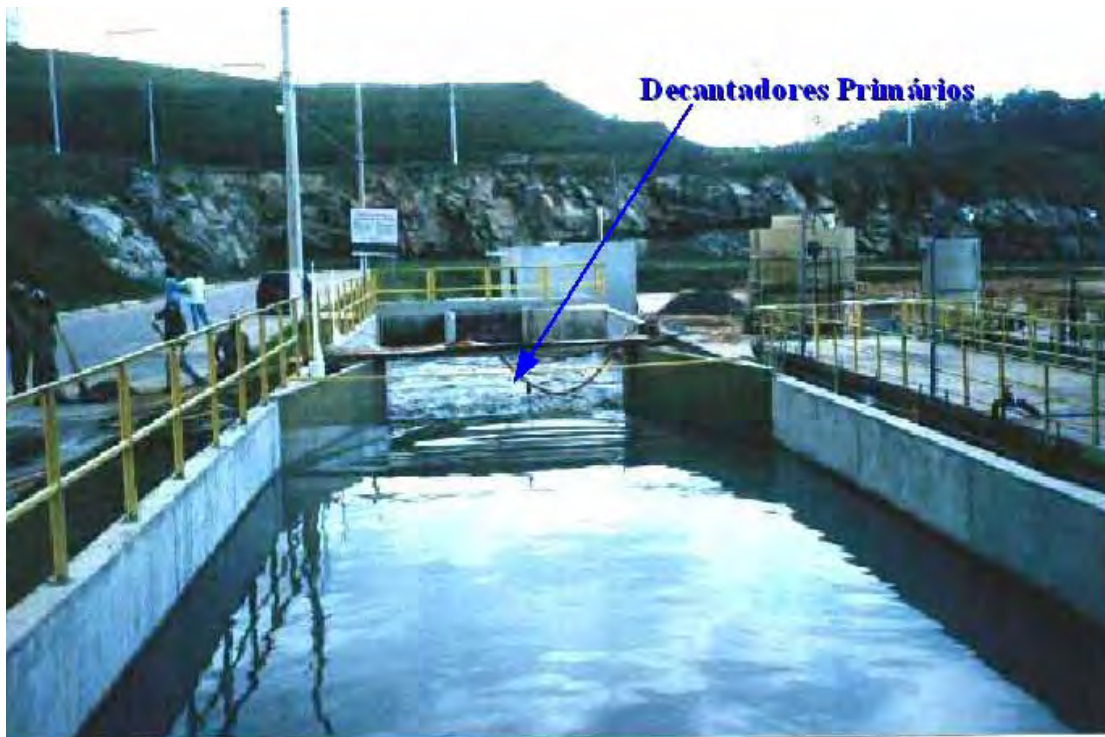
Figura 8 – Tratamento primário do esgoto (Fonte: http://www.copasa.com.br/media/arrudas_primario.jpg – 02/07/2005)
