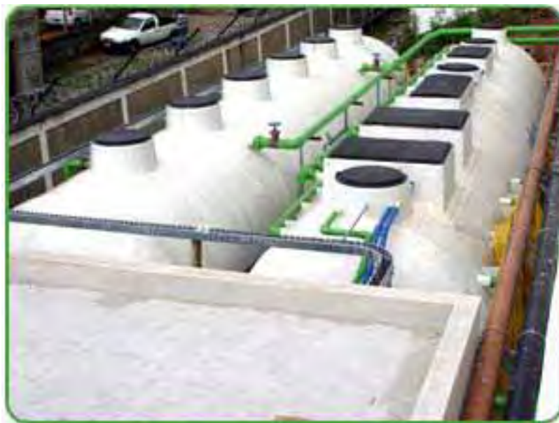
Figura 42 – Estação de tratamento de esgoto MIZUMO Linha Plus
