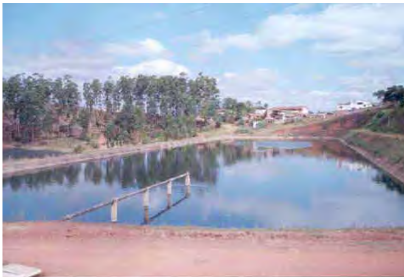
Figura 10 – Lagoa de estabilização (Fonte: http://www.etg.ufmg.br/tim2/tratamento2.ppt – 17/03/2007)
