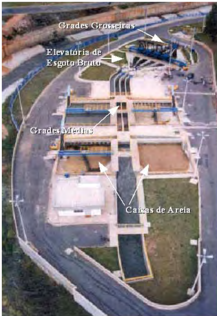
Figura 7 – Tratamento preliminar do esgoto (Fonte: http://www.copasa.com.br/media/arrudas_preliminar.jpg – 02/07/2005)
