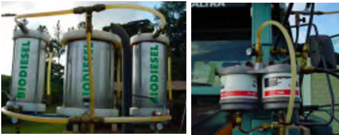
FIGURA 8. Reservatórios de combustível à esquerda e filtros auxiliares à direita.
