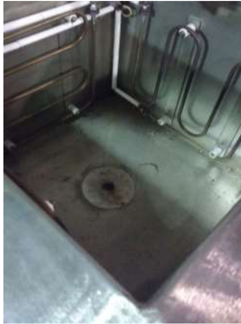
Figura 20 – Elementos de aquecimento
