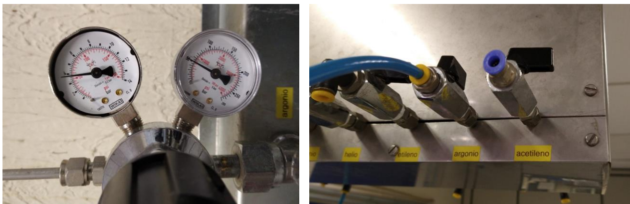
Figura 19 - Detalhe do manômetro instalado junto a linha de argônio com pressão estabelecida em aproximadamente 4 bar e da válvula de retenção da linha de gás utilizada para estabelecimento de atmosfera controlada.
